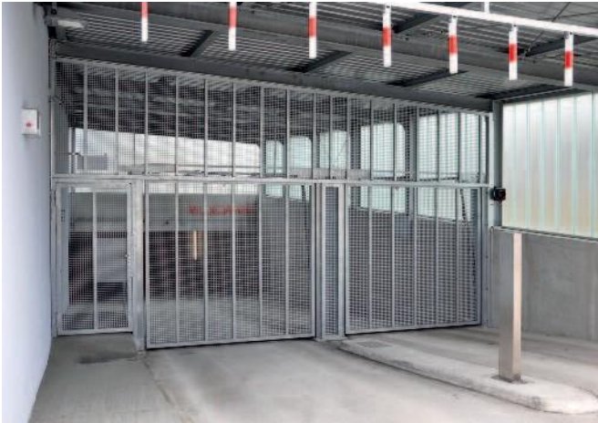
Feuerverzinkte Toranlage mit Nebentüre und Sturzverkleidung
